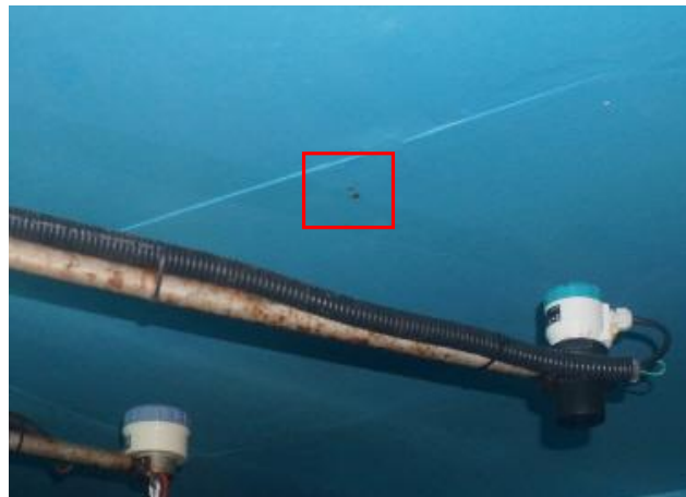
배수지1지 상부슬래브 녹
