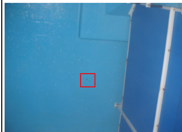
배수지2지 상부슬래브 녹
