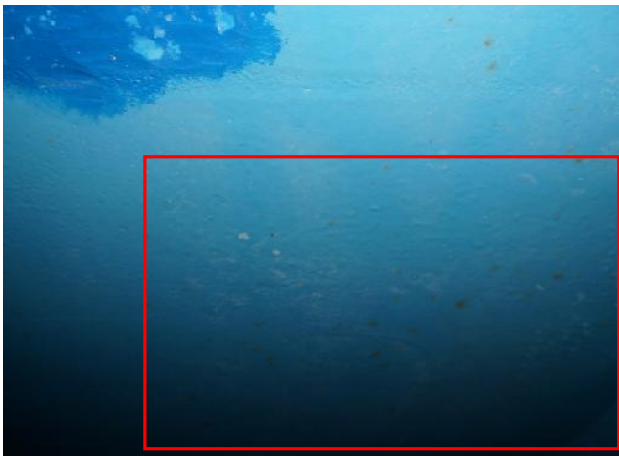
배수지1지 상부슬래브 백태
