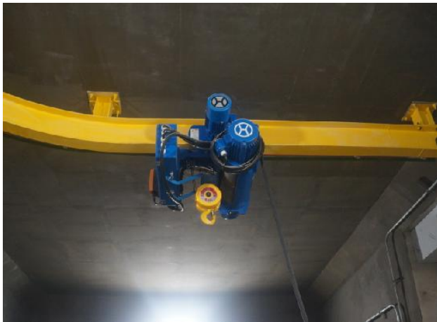
유입밸브실 호이스트 상태양호
