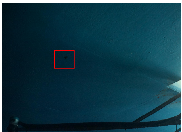
배수지2지 상부슬래브 녹
